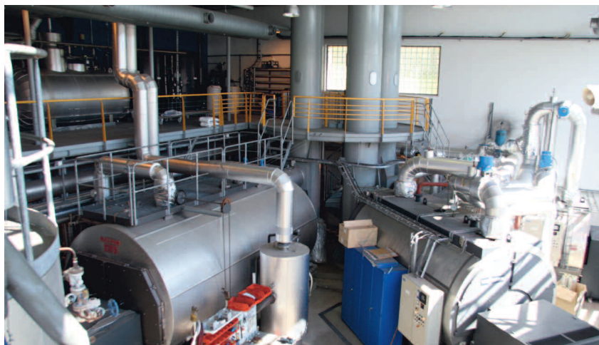
De tekniska försörjningssystemen är starkt centraliserade på Rikshospitalet. En driftcentral försörjer hela sjukhuset med värme, ånga och isvatten. En stor glasvägg gör lokalen mycket ljus och styr kraften vid en eventuell explosion ut ur byggnaden.
